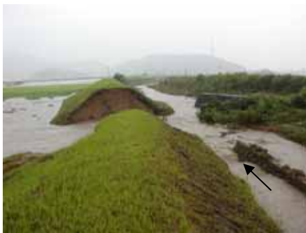
破堤した人数川 (田布施町大波野地区)
