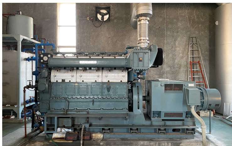
ポンプ運転用予備発電機の設置事例
