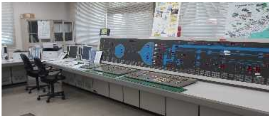
センター監視設備の現況 [木屋川・木屋川第2期工業用水道]
