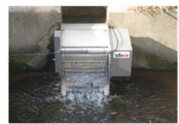
小水力発電施設
