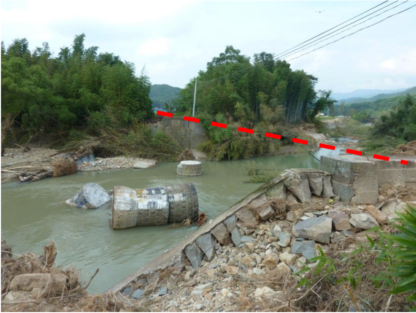
阿武川第5橋梁流失
