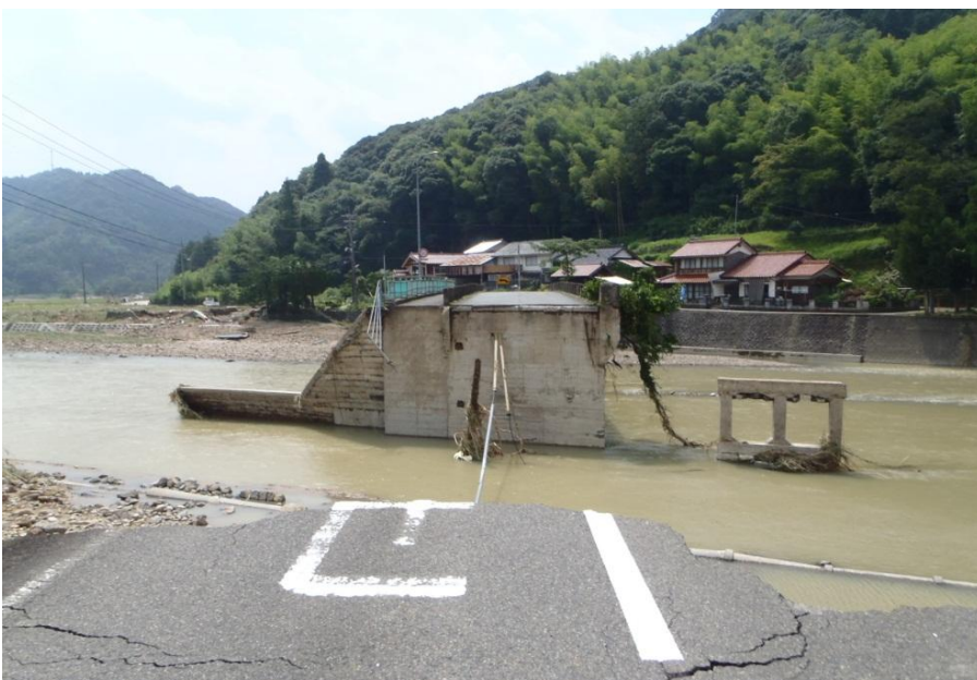
萩市中小川 主要県道益田阿武線 橋台背面流失
