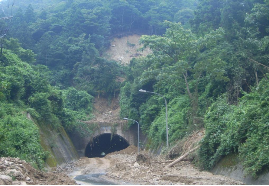
萩市唐津 一般国道315号 法面崩壊
