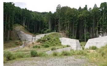
土砂災害防止施設
