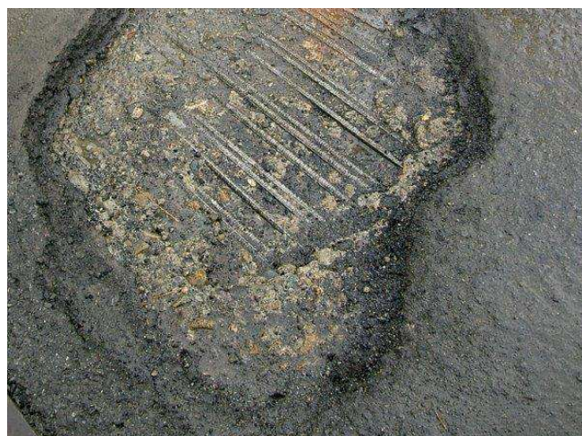
床版コンクリートの土砂化
