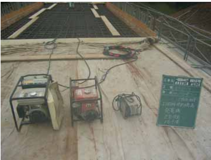
発電機のチェック
