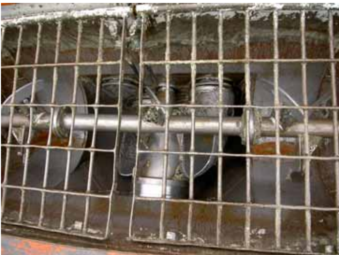
ポンプ車のチェック
