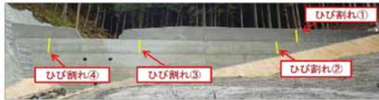
ひび割れ発生状況
