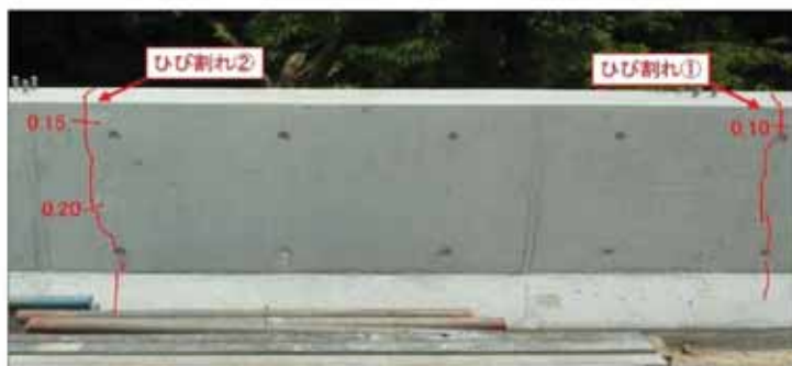
ひび割れ発生状況
