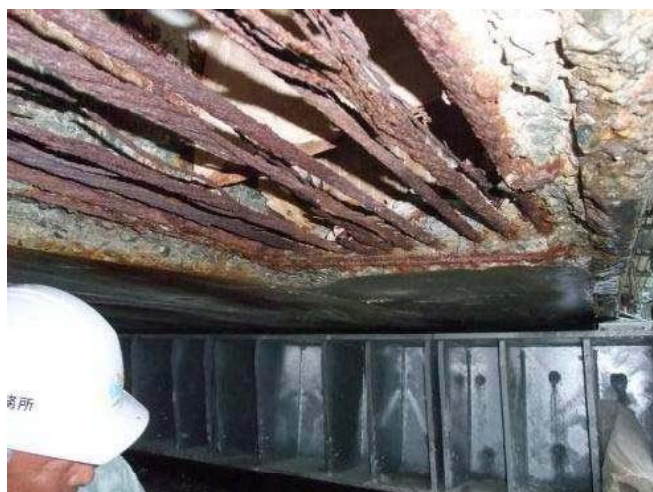
桁下面のPC鋼材の腐食、破断状況 硬化コンクリート中の空気量は約0%
