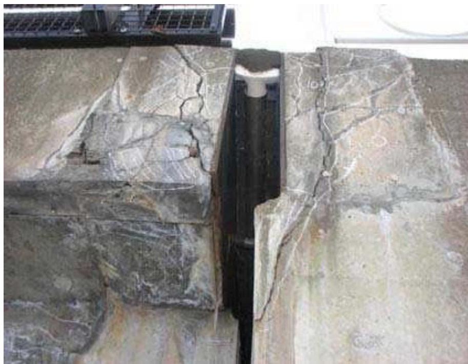
桁端部の漏水の影響範囲に発生したひび割れ。 橋梁点検でもアルカリ骨材反応の疑い
