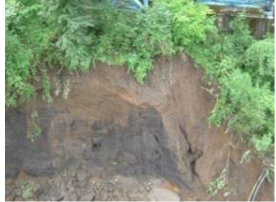
＜谷側地盤の流出＞
