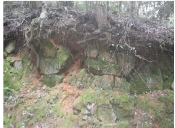
＜落石の可能性がある法面＞
