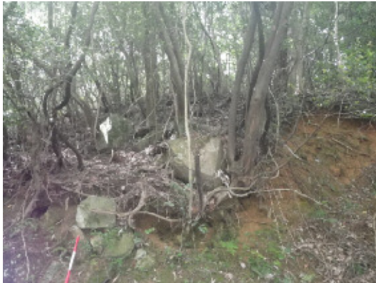
＜落石の可能性がある法面＞
