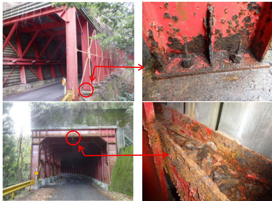
<山間部における損傷状況>
