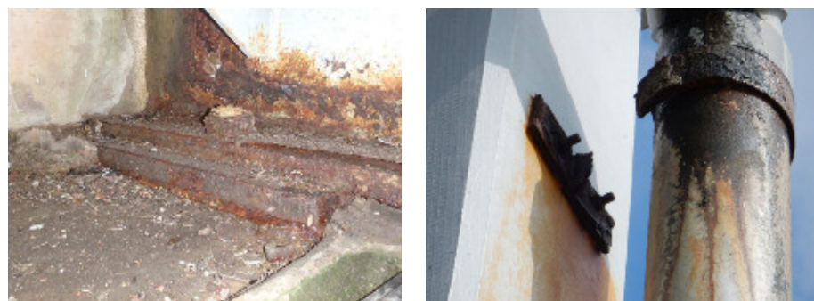
<その他の損傷状況>
