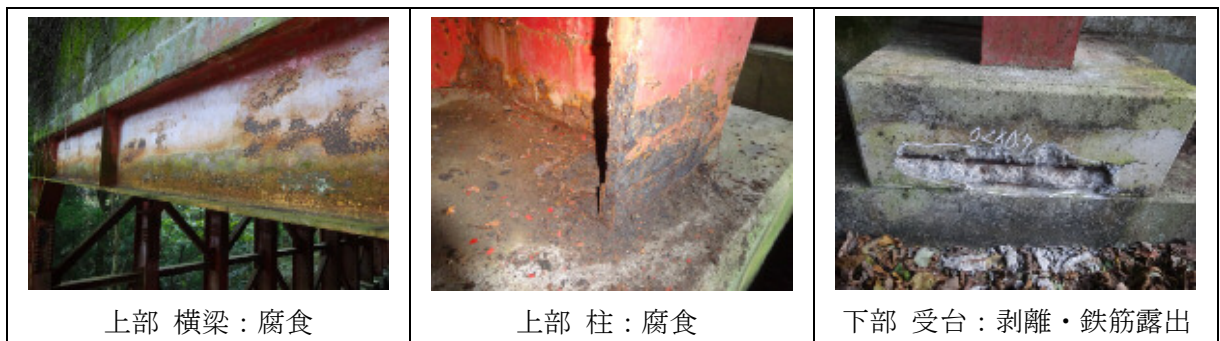
<主な損傷状況（鋼製シェッド）>
