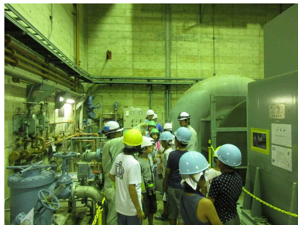
《生見川発電所》
