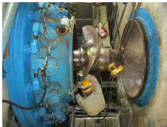
≪水越発電所 水車発電機≫
