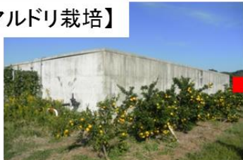
水源の確保(貯水槽)
