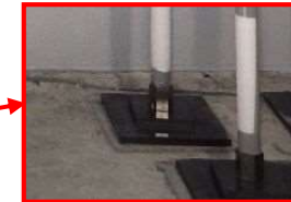
【ナットの状況】 ・ 設置当初 (12/21) ⇒ 手締め (遊間なし) ・ 現状 (1月時点) ⇒ 変状なし
