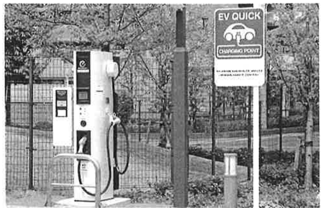
電気自動車 充電ステーション
