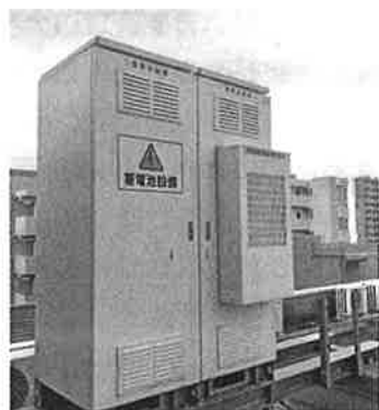
マンションなどの共用部の蓄電池設備
