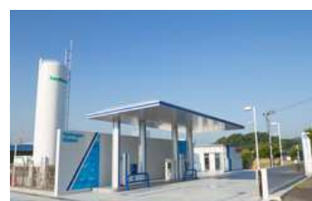
水素ステーション（周南市） 「◎ 岩谷産業株式会社」
