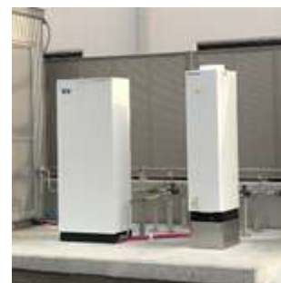
純水素型燃料電池 コジェネレーションシステム
