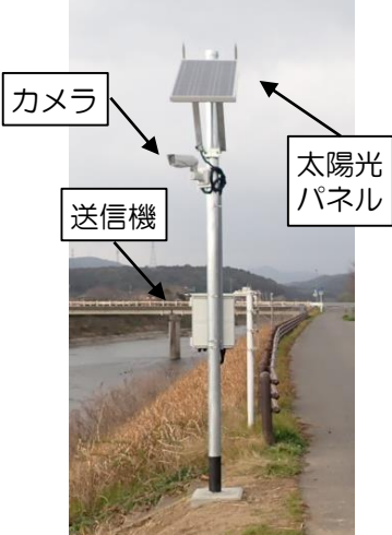
▲河川監視カメラ
