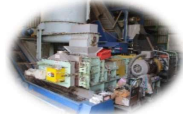
破碎・圧縮固化施設
