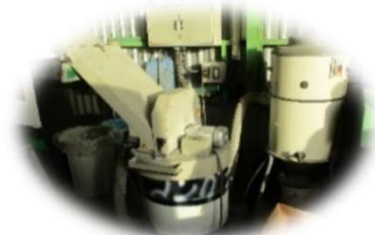
蛍光灯破碎施設
