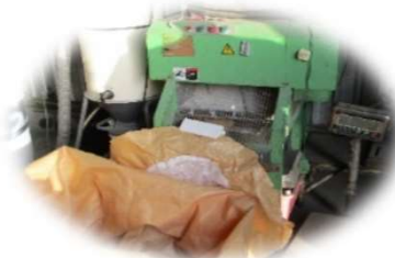
石膏ボード破碎施設
