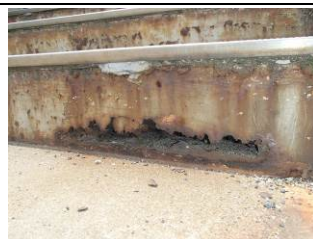
蹴上げ：腐食、欠損
