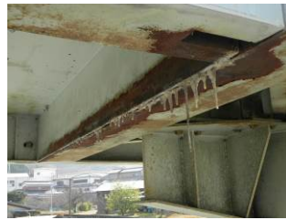
主桁、横桁：腐食、遊離石灰
