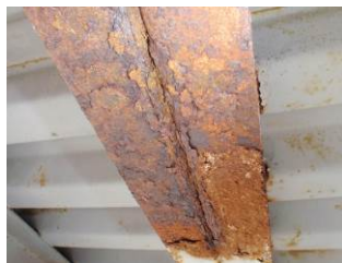
主桁、床版：腐食
