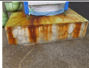
根巻きコンクリート：腐食、ひびわれ
