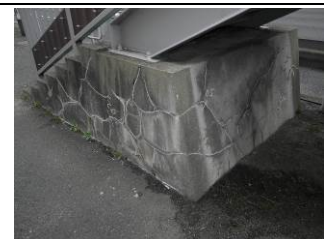
橋台：ひびわれ
