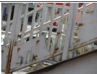
裾隠し板：欠損
