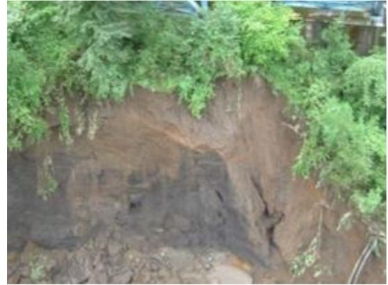
＜谷側地盤の流出＞
