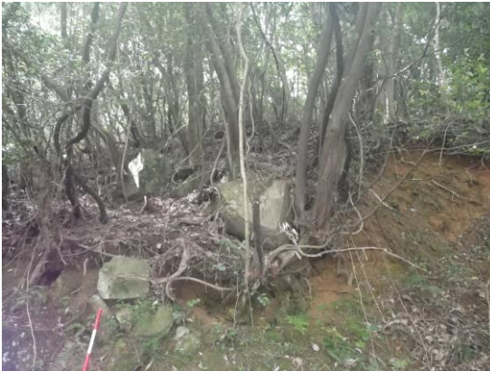
＜落石の可能性がある法面＞
