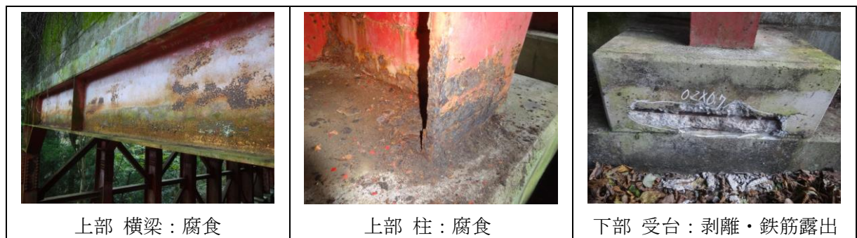
&lt;主な損傷状況（鋼製シェッド）&gt;
