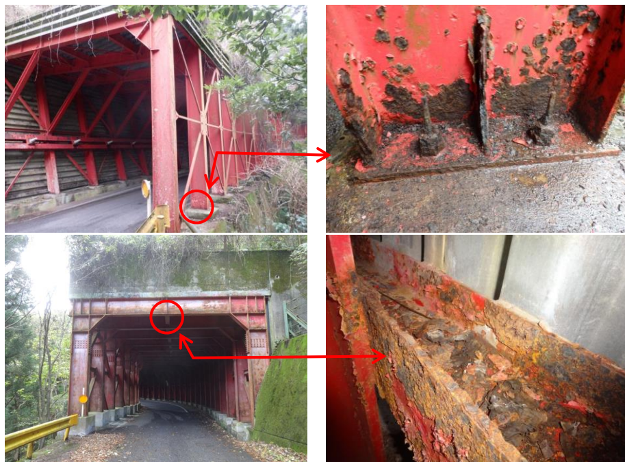
<山間部における損傷状況>
