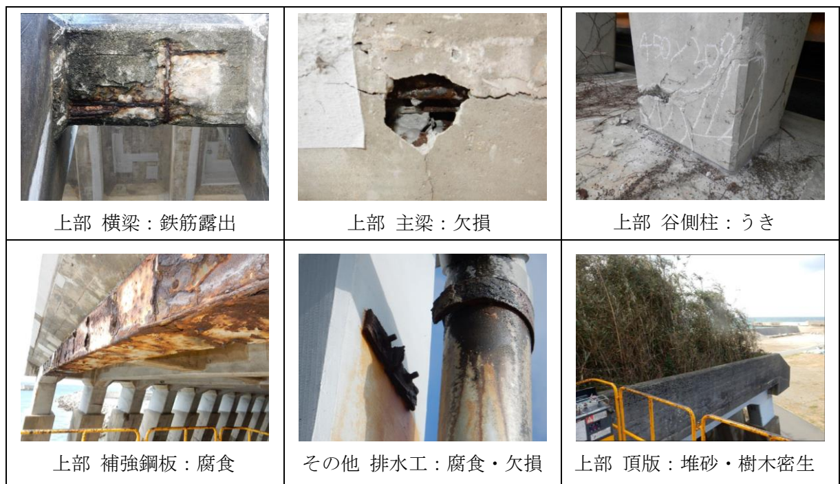
&lt;主な損傷状況（コンクリート製シェッド）&gt;
