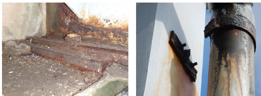
<その他の損傷状況>
