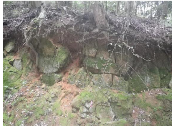
＜落石の可能性がある法面＞
