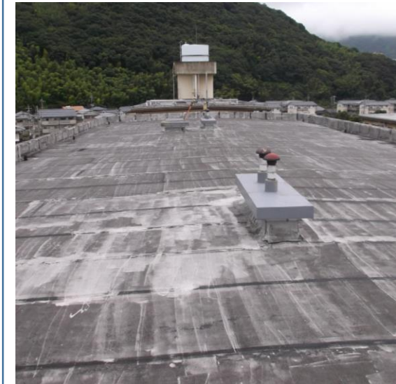
県営住宅屋根防水劣化
