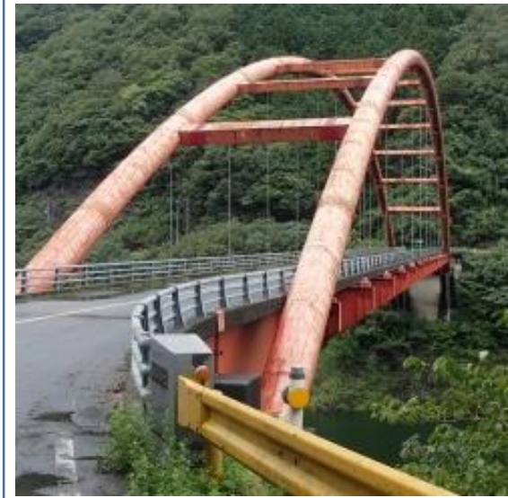
鋼橋塗装劣化
