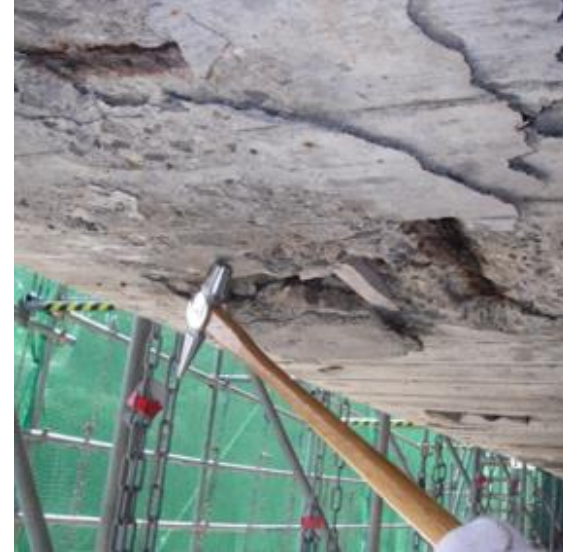
橋梁床版劣化
