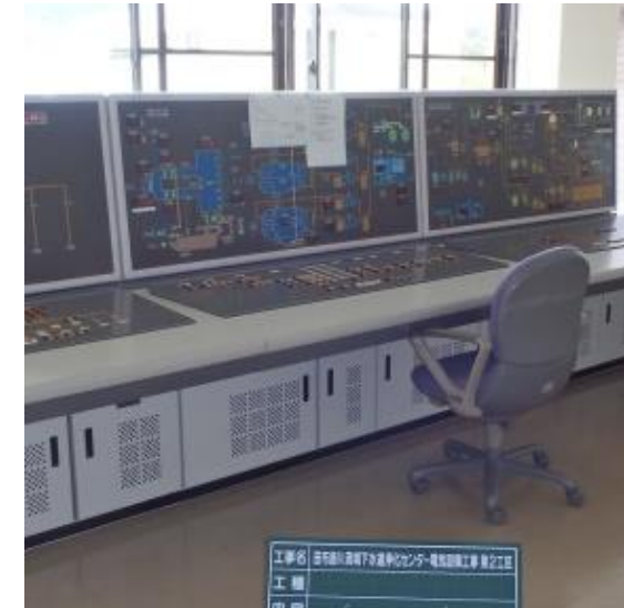
下水処理場監視制御装置
