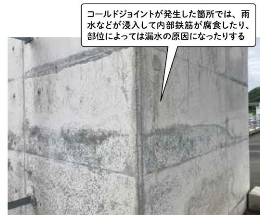
許容打重ね時間を超えて上層を打ち重ねた場合や、上層と下層が一体化するような締固めができていない場合にコールドジョイントが発生する(写真:山口市)
