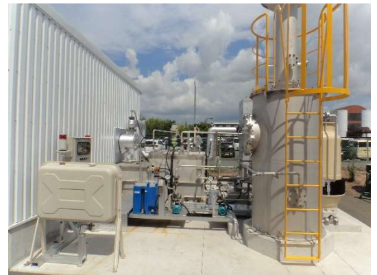
金属ナトリウム処理システム
