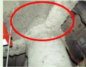
吹付け石綿 (レベル1)
