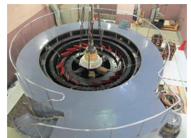
菅野発電所 水車発電機
