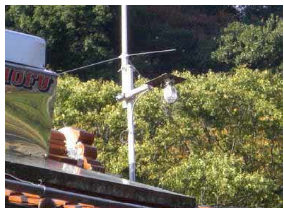
民家に設置した固定基地局(仁保)
