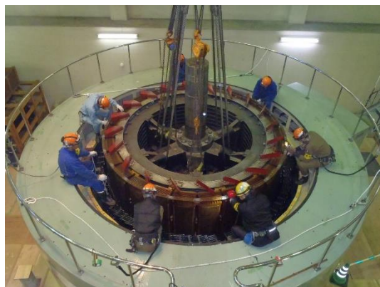
《新阿武川発電所 発電機》
