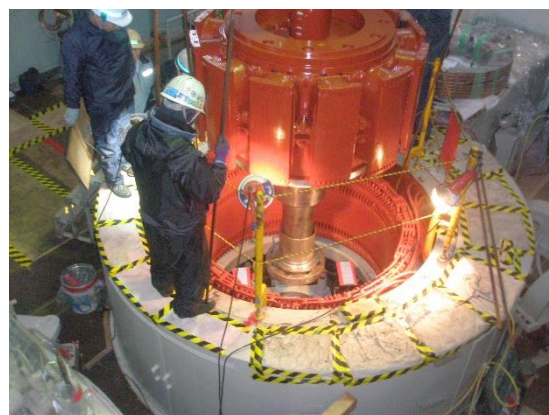
《木屋川発電所 発電機》
