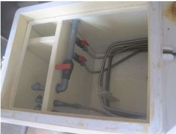
海水冷却装置を設置した活け間
