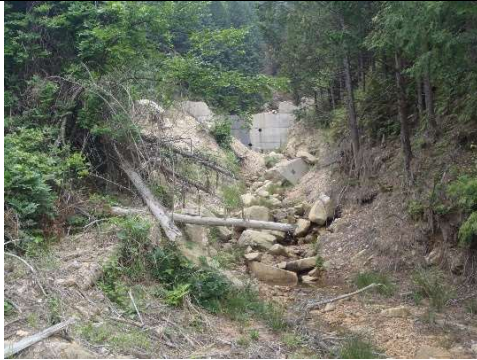
被災した治山施設
