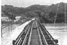
梁野川の線路橋脚が傾き、長門市駅～小串駅間の運休が続く。(画像提供:JR西日本)
