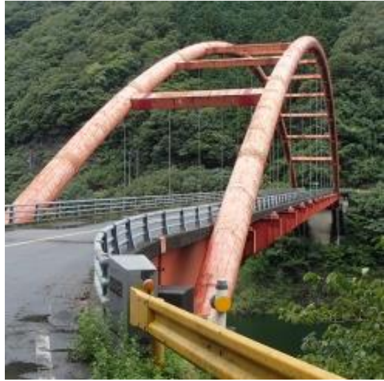
鋼橋塗装劣化
