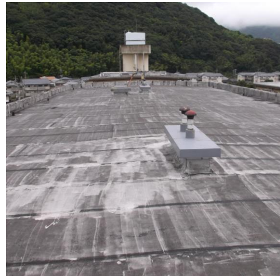
県営住宅屋根防水劣化
