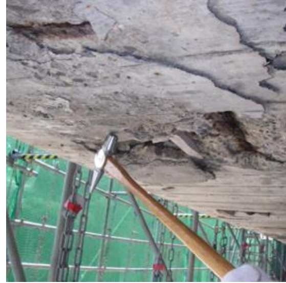
橋梁床版劣化
