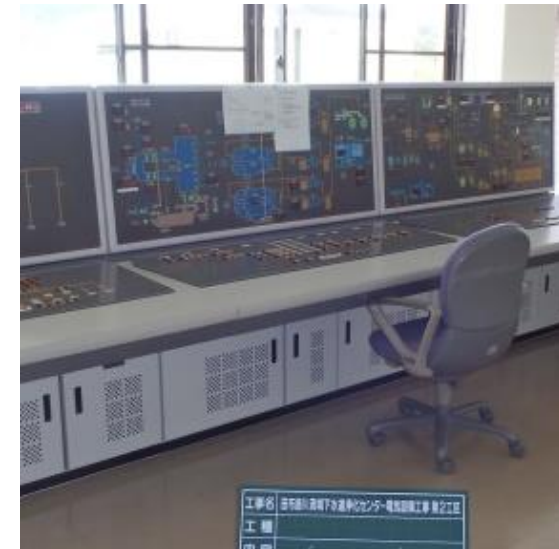
下水処理場監視制御装置
