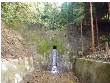
実施前（クラック発生）
