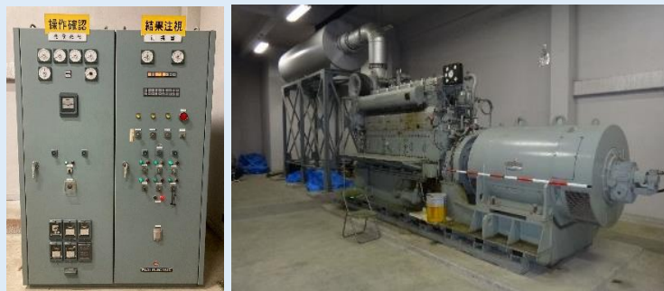
≪ポンプ動力用予備発電機の現況≫
