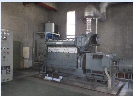
古祖原ポンプ場予備発電機現況 [佐波川工業用水道]
