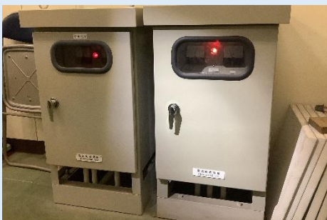
電食防止装置現況 [小瀬川工業用水道]
