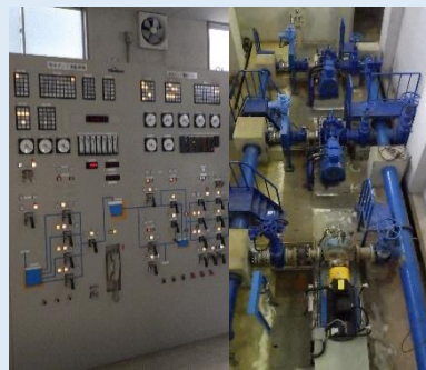
美祢送水ポンプ場電機設備現況 [厚狭川工業用水道]
