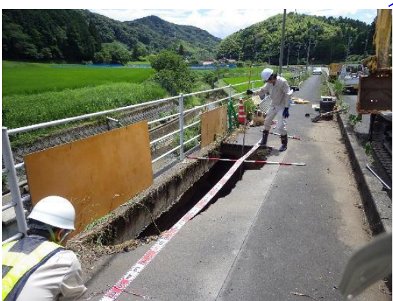
県道下関美祢線【道路災】 （下関土建）
