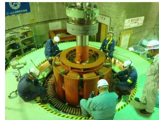
《徳山発電所 発電機》
