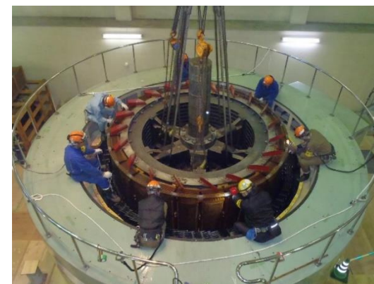
《新阿武川発電所 発電機》
