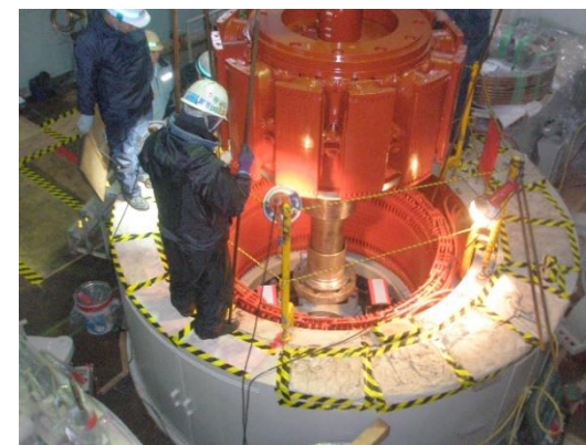
《木屋川発電所 発電機》
