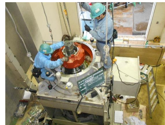
《末武川発電所 発電機》
