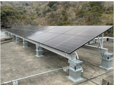
太陽光発電設備
