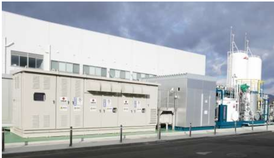
アルカリ水電解装置全体（電解槽は本装置内に組み込み）
