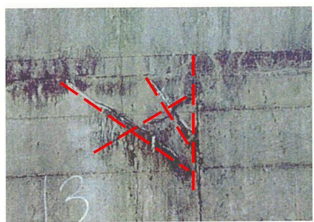
写真-1 ブロック化したひび割れの例
