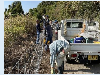
町道沿い設置状況
