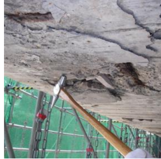
橋梁床版劣化
