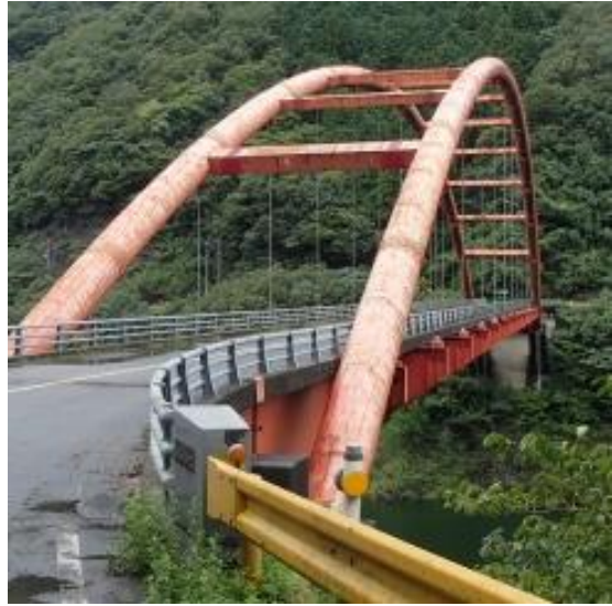
鋼橋塗装劣化
