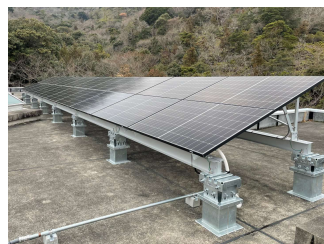
太陽光発電設備
