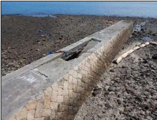
健全度 A(突堤) 天端の沈下
