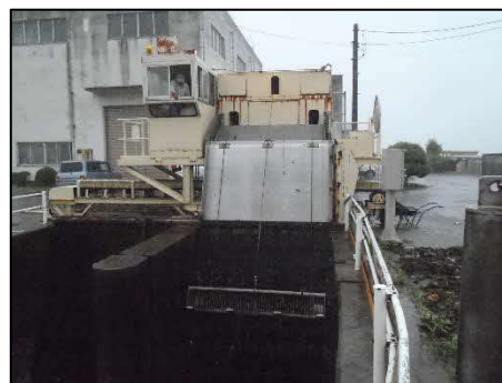
排水施設 (除塵設備の老朽化)
