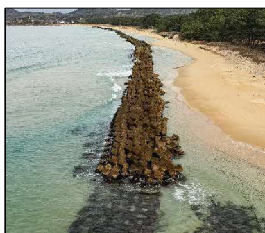
離岸堤(移動・沈下・散乱)
