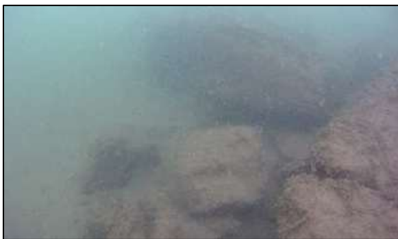
健全度 C(潜堤) 移動・散乱
