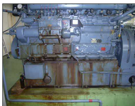
排水施設 (駆動設備の老朽化)
