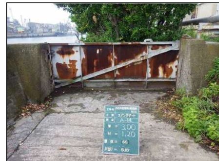
陸閘（扉体腐食）
