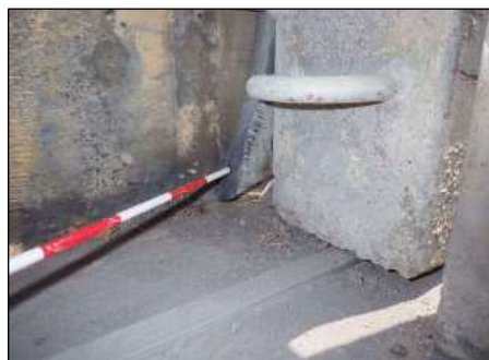
陸閘（水密ゴム破損）
