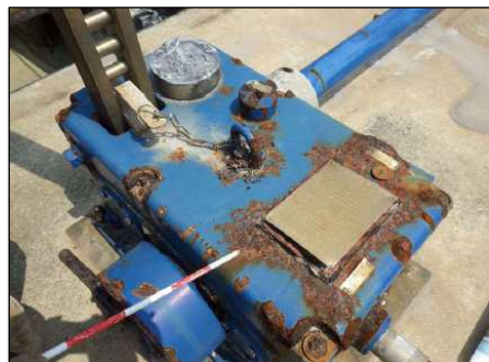
樋門（開閉装置腐食）
