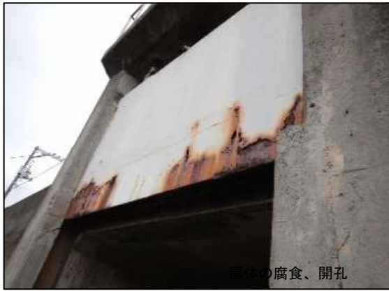
健全度A* (腐食や変形が著しい)
