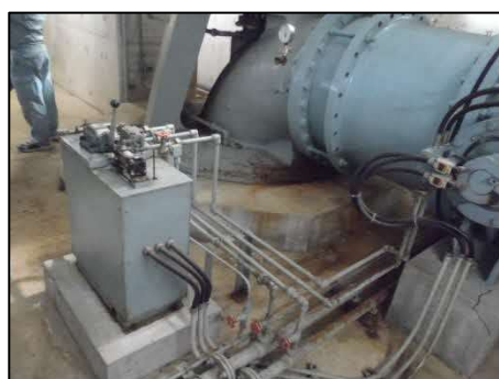
排水施設 (主ポンプの腐食)
