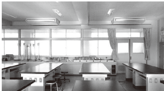
《空調整備事例》
