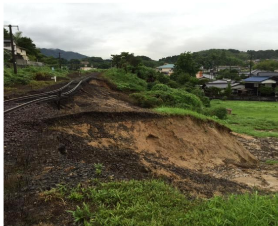
▽平成 30 年 7 月豪雨災害(被災箇所)
