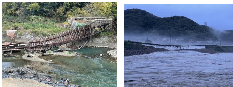
▲令和 5 年 (2023 年) の豪雨による被害状況
