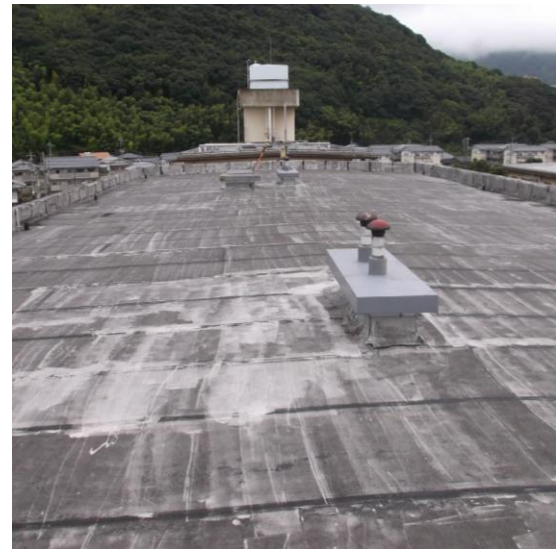
県営住宅屋根防水劣化
