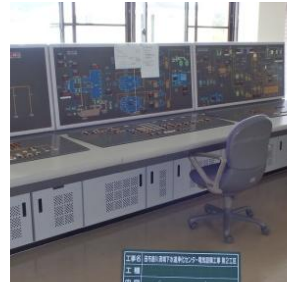
下水処理場監視制御装置
