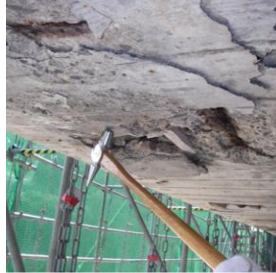
橋梁床版劣化
