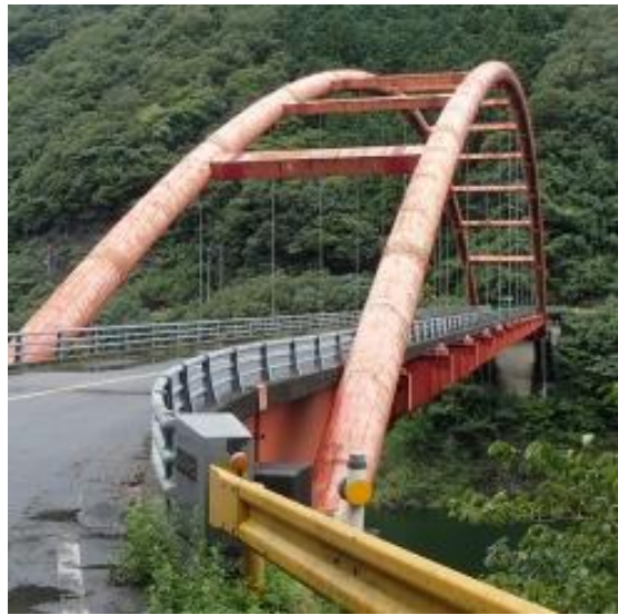
鋼橋塗装劣化
