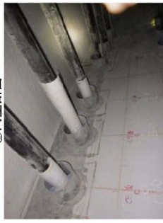
⑦PC貫通孔状況
