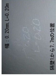
④削壁 ひびわれ
