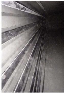
④PC鋼材状況
