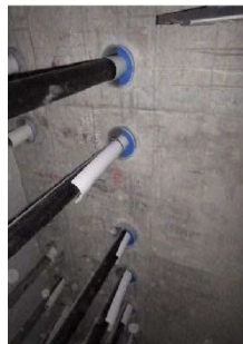
⑧隔壁1 PC貫通孔状況
