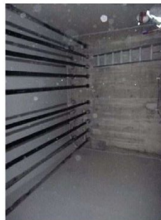
⑩隔壁、PC貫通孔状況
