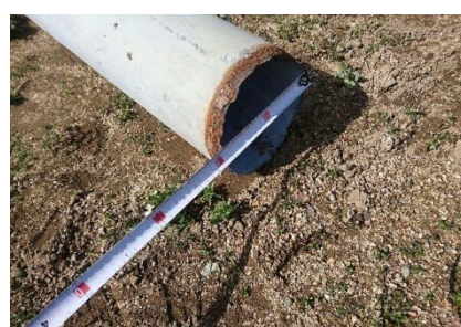
ポールの根腐れによる倒壊
