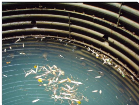
写真 3.2 地すべり防止施設の変状事例（集水井工の水没（排水路の閉塞）：変状レベル c）
