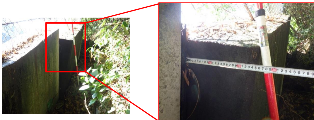
写真 3.3 急傾斜地崩壊防止施設の変状事例（待受擁壁工の変形：変状レベル c）
