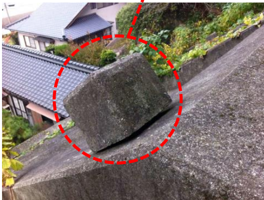
写真 5.10 アンカー工の浮き上がり （緊張力低下・喪失）
