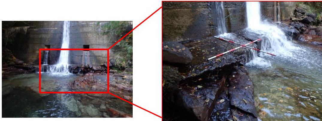
写真 3.1 砂防堰堤の変状事例（基礎部の洗掘：変状レベル c）
