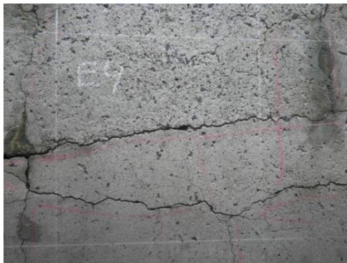
写真 5.1 劣化損傷状況
