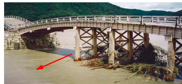
平成17年9月：台風14号_錦帯橋補助橋脚流出
