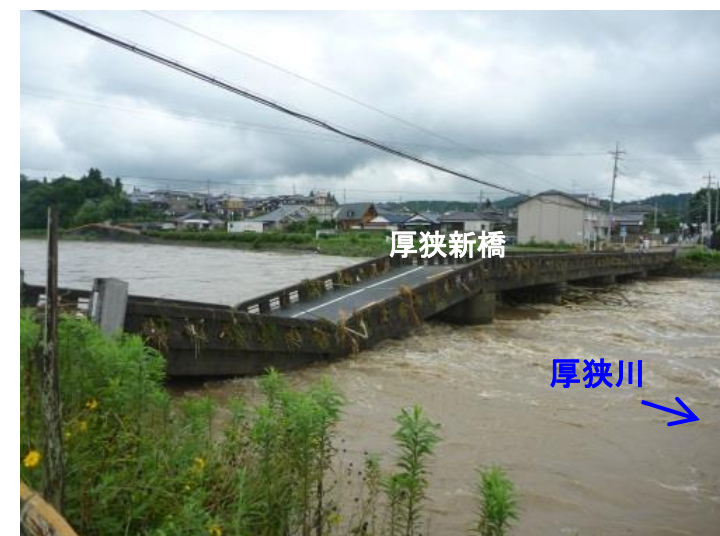
平成22年7月15日洪水: 厚狭川(厚狭新橋付近)
