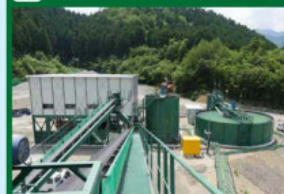
0 濁水処理設備 (骨材製造用)
