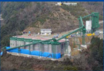
1 骨材貯蔵設備 (ダムサイト)
